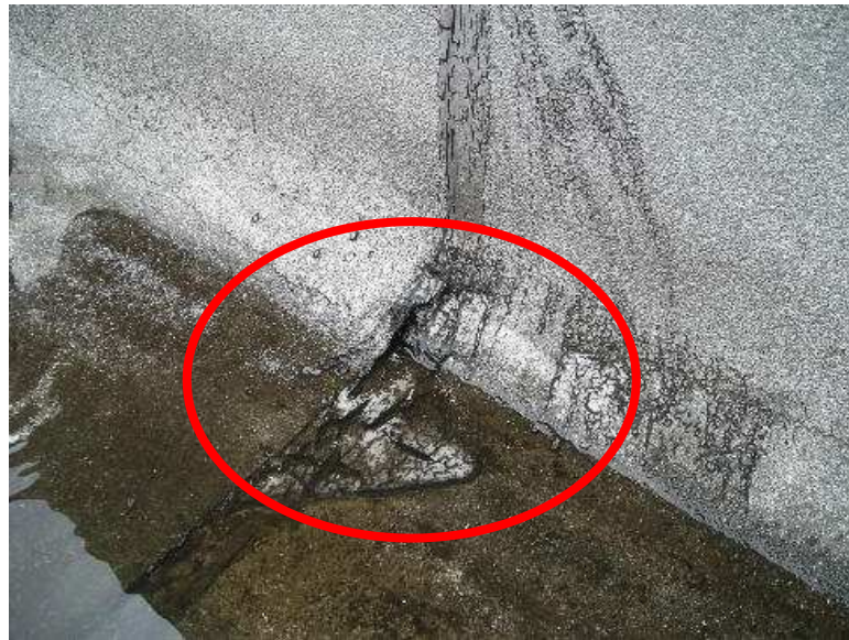
防水層のジョイント部口開き
