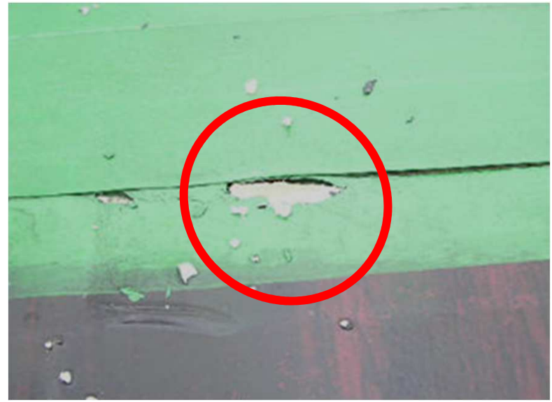
鳥害による損傷(断熱ゴムシート)
