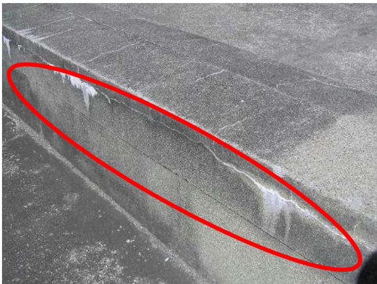
パラペット笠木部の ひび割れ・浮き
