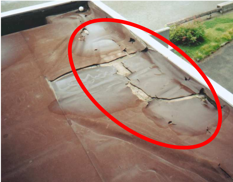
シートの破断・損傷
