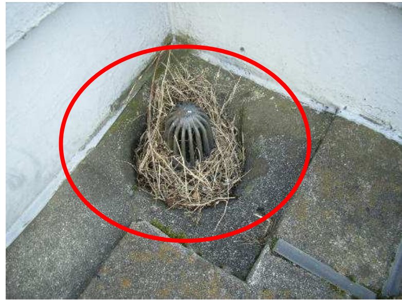
ドレン廻りモルタルのひび割れ 土砂の堆積
