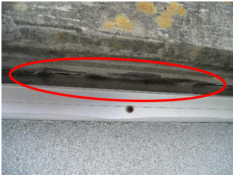
立上り端部の押え金物上部 シーリングの硬化・破断
