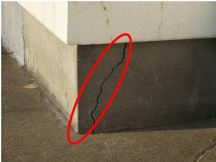
立上り部 モルタル押え面ひび割れ
