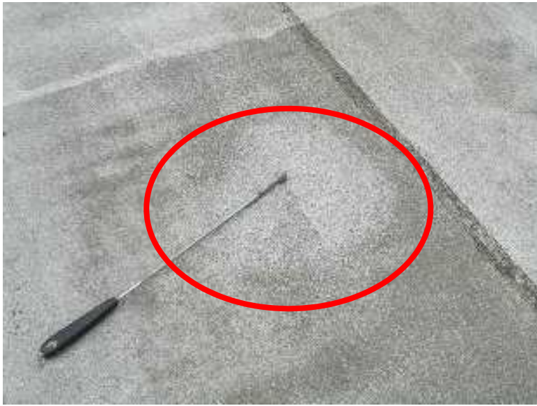
防水層のふくれ
