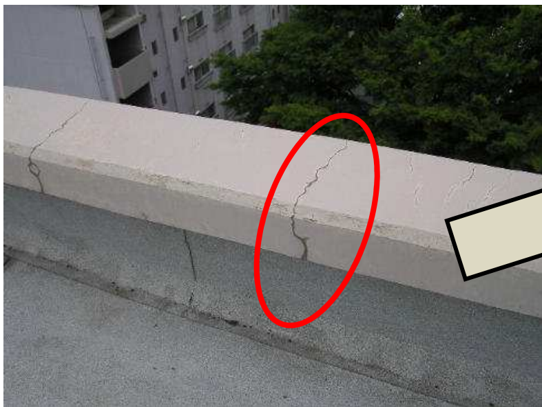
パラペット笠木部のひび割れ
