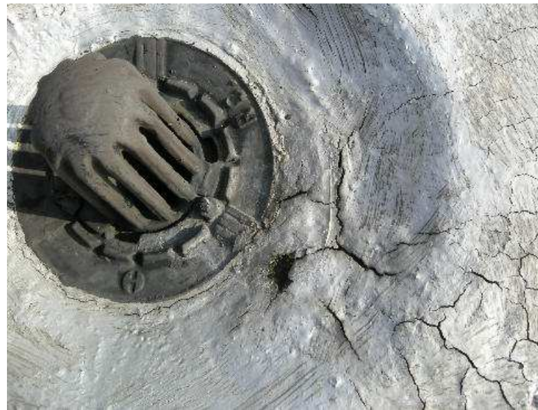
ドレン周辺部防水層の破断
