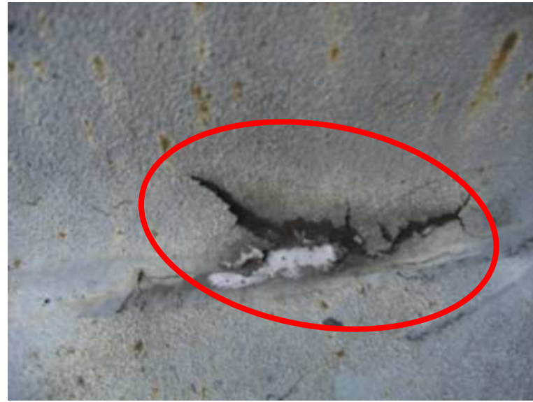
防水層の破断・損傷
