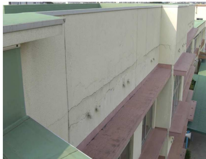
外壁の水平なひび割れ →パラペットの押し出しが原因
