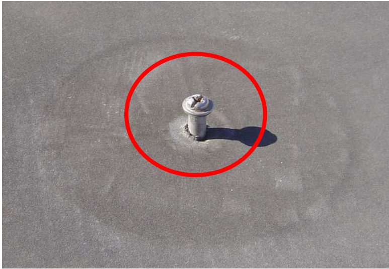
アンカーの抜け
