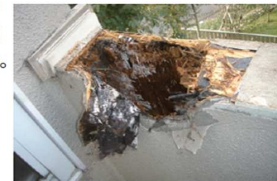
ベランダ笠木取合い部 からの漏水・腐朽例
